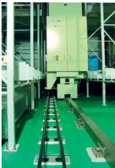
● Многоярусный склад в чистом производственном помещении
