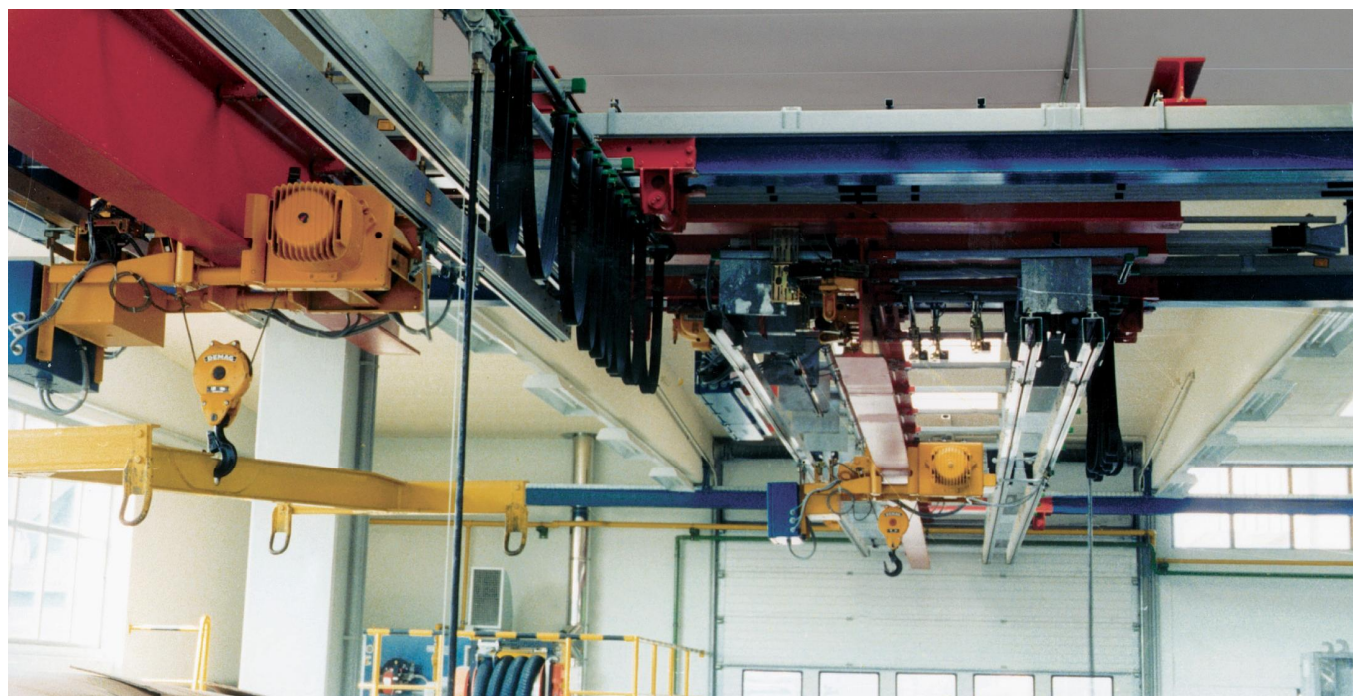
● Безопасный троллейный шинопровод на мостовом кране
