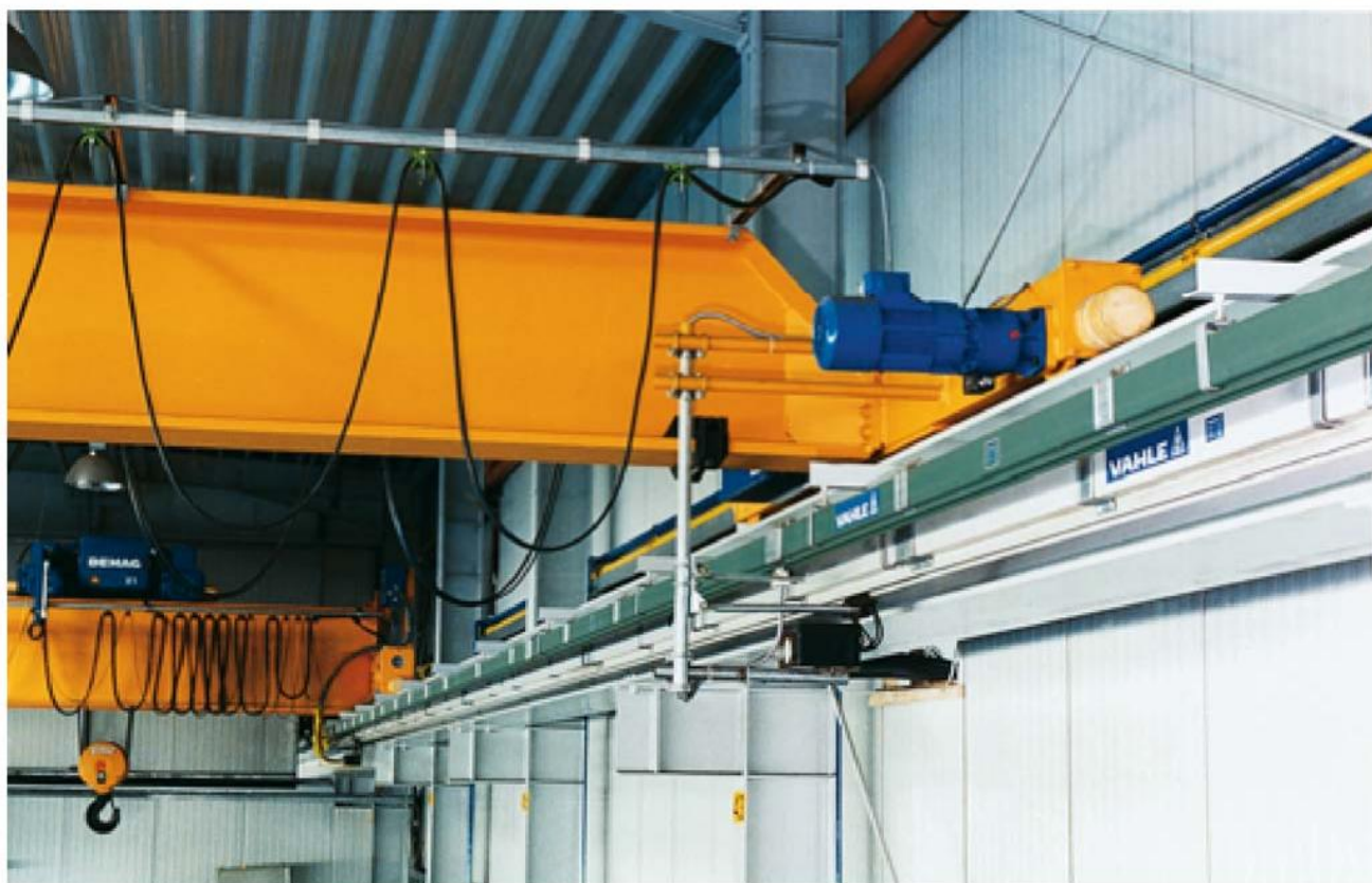
Пластмассовый шинопровод для электропитания цехового крана.
